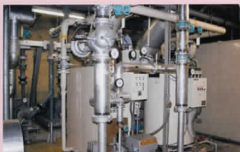
ボイラー室です。館内の温湿度を一定に保ちます。
